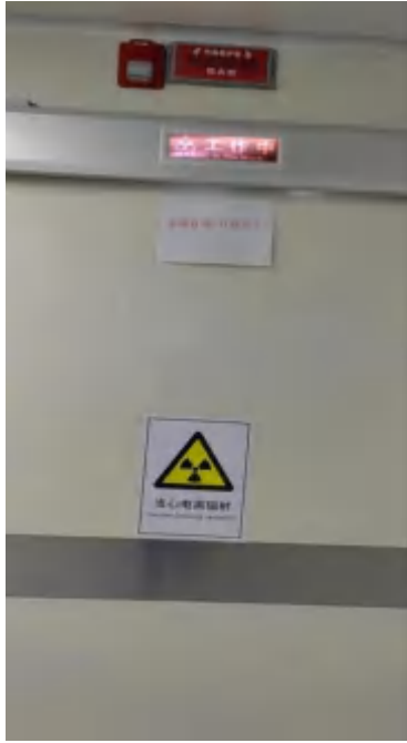
图 3-2 防护门门灯联动现场照片
